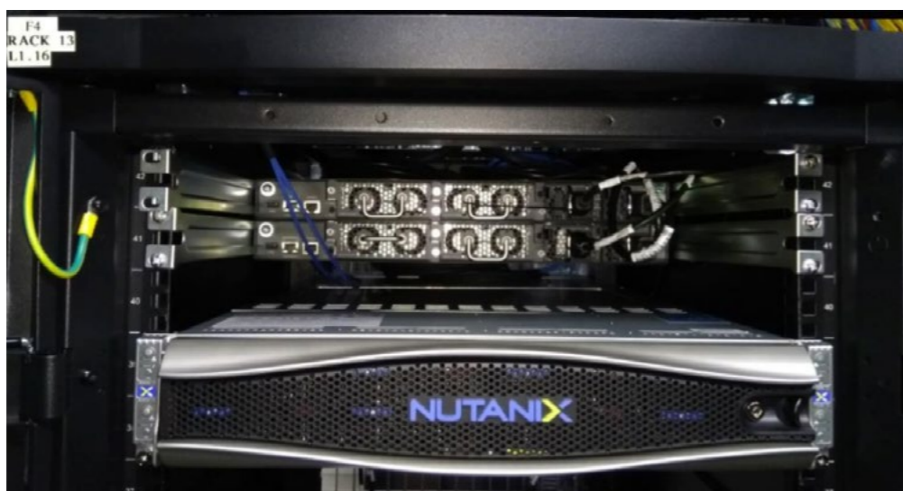
Fig. 35. Vista frontal – Instalación Física y rackeo de servidor Nutanix
